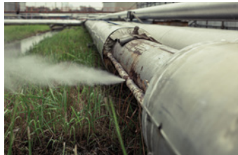
Une fuite de gaz
